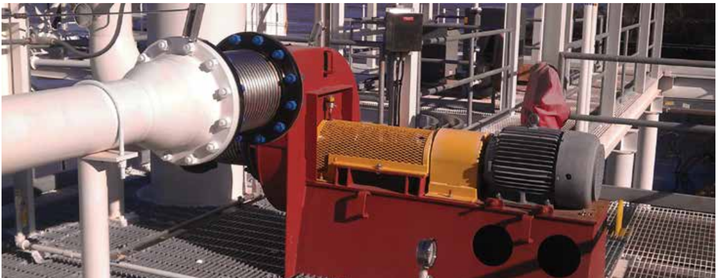
VAPOR BLOWER UNIT
